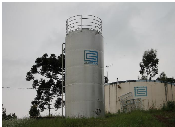
Figura 18 - Reservatórios 1 e 2, Av. Independência. Fonte: Secretaria de Administração Prefeitura
