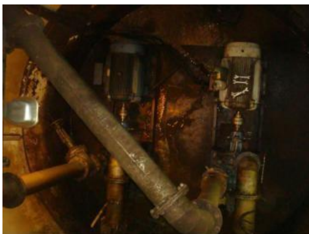
Figura 13 - Conjunto motor-bomba e tubulações da estação elevatória de água bruta. Fonte: Plano Municipal de Saneamento Básico de Viadutos (2011).
