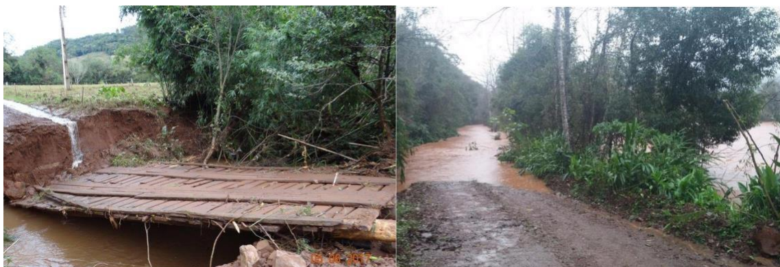
Figura 33 - Danos causados pela inundação de rios na zonal rural do município. Fonte: Prefeitura Municipal de Viadutos (2017).
