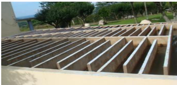
Figura 15 - Tanque de floculação da ETA.
