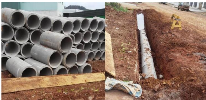
Figura 32 – Tubos de concreto com diâmetro de 30 cm usados nas tubulações pluviais subterrânea da Rua Pe. Henrique Koch.
